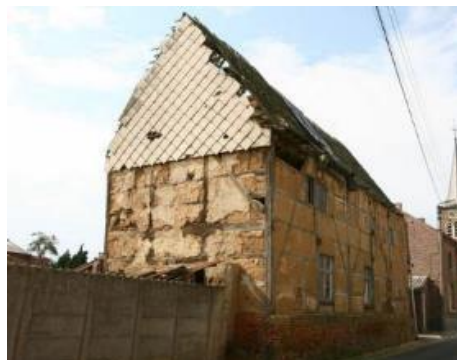
Figuur 11 De zestiende-eeuwse Sint-Petrushoeve was het oudste bouwwerk van Attenhoven. Na lang verval stortte in mei 2008 de hoeve uit lemen vakwerk definitief in. In 2010 kocht het Landense stadsbestuur het monument aan om het te renoveren.
